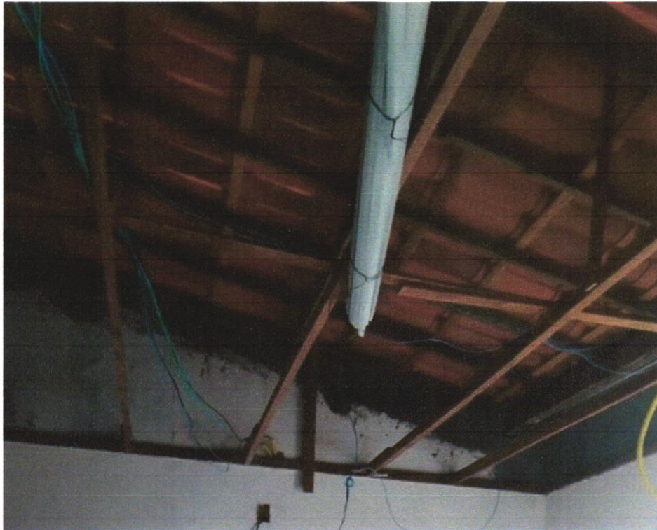
Foto 37 - CABO DE COBRE FLEXÍVEL ISOLADO, 2,5 MM 2 , ANTI-CHAMA 450/750 V, PARA CIRCUITOS TERMINAIS - FORNECIMENTO E INSTALAÇÃO. AF_12/2015
