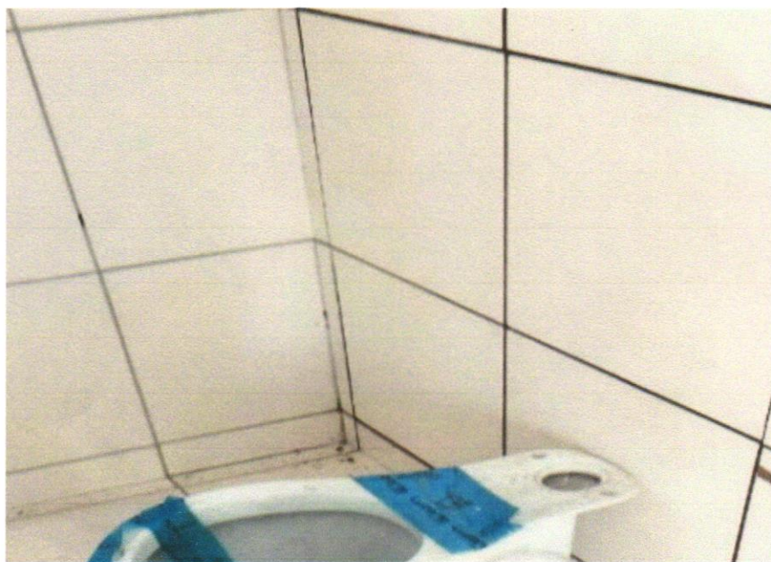
Foto 13 - REVESTIMENTO CERÂMICO PARA PAREDES INTERNAS COM PLACAS TIPO ESMALTADA EXTRA DE DIMENSÕES 33X45 CM APLICADAS EM AMBIENTES DE ÁREA MAIOR QUE 5 M 2 A MEIA ALTURA DAS PAREDES. AF_06/2014
