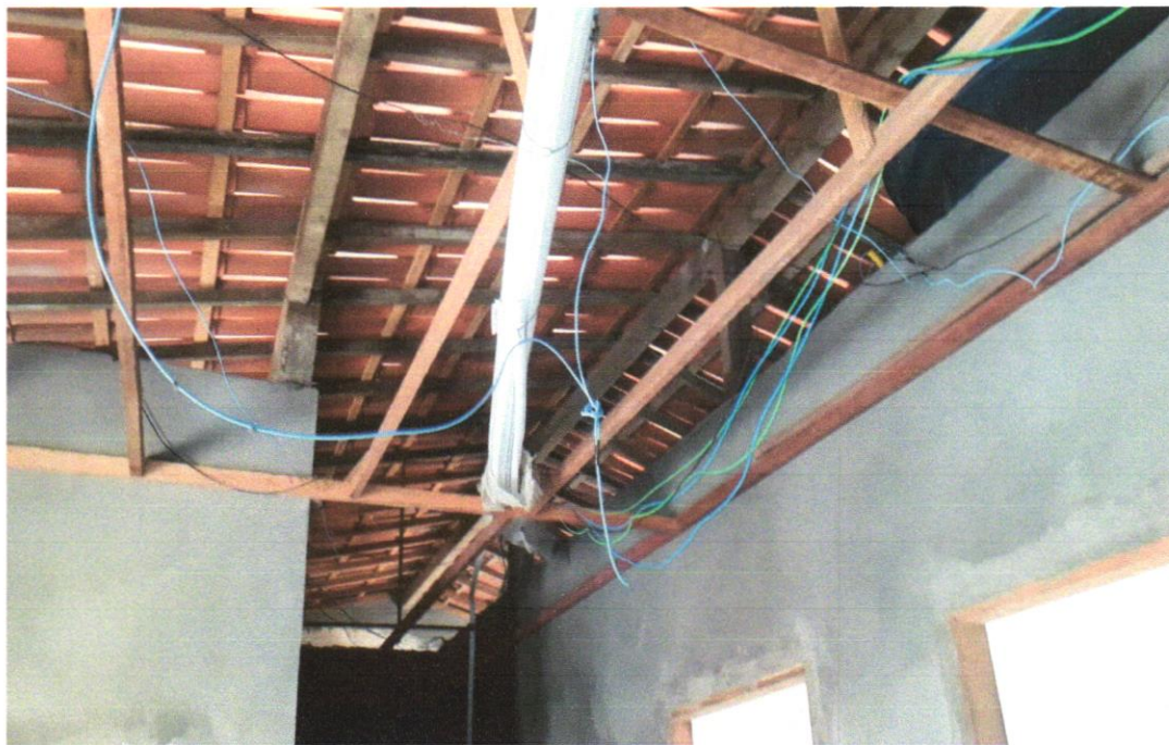
Foto 35 - CABO DE COBRE FLEXÍVEL ISOLADO, 4 MM 2 , ANTI-CHAMA 0,6/1,0 KV, PARA CIRCUITOS TERMINAIS - FORNECIMENTO E INSTALAÇÃO. AF_12/2015
