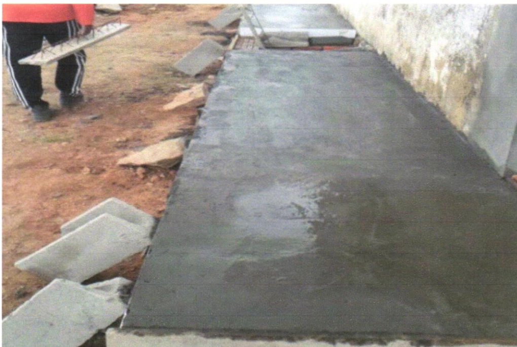
Foto 15 - EXECUÇÃO DE PASSEIO (CALÇADA) OU PISO DE CONCRETO COM CONCRETO MOLDADO IN LOCO, USINADO, ACABAMENTO CONVENCIONAL, NÃO ARMADO. AF_07/2016
